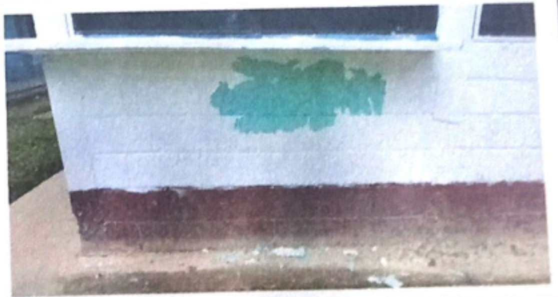
Foto 6: Deterioro de la pintura impermeabilizante
